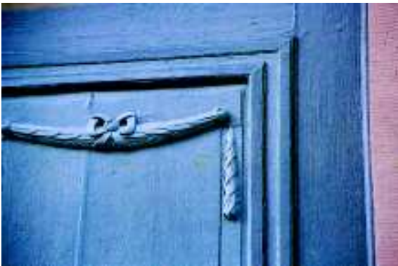
Abb. 138: An der gut gepflegten Holzfüllungstür erkennt man die ortsverbundene Einstellung des Eigentümers zu seinem Haus.
