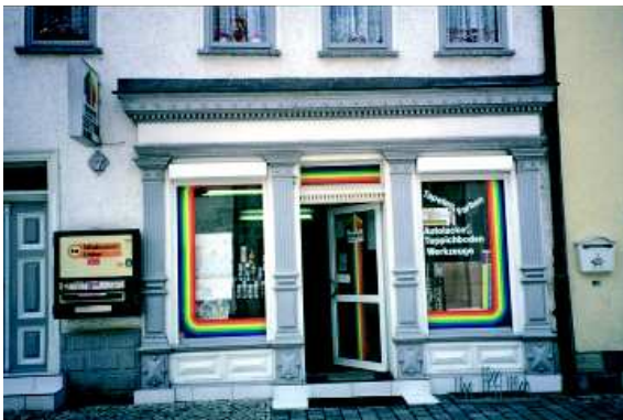
Abb. 199: Gebäudefassade im Zustand vor der Sanierung. Mit der Sanierung wurde auch der störende Automat entfernt.
